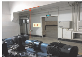
图 1 回油箱现场安装图
