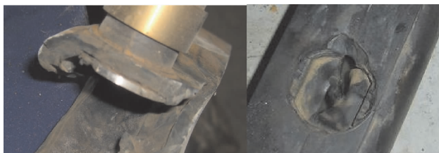
图3 空气围带气嘴脱落
