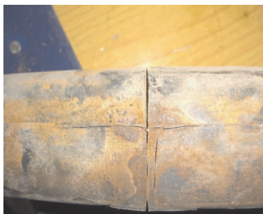
图1 空气围带本体老化开裂
